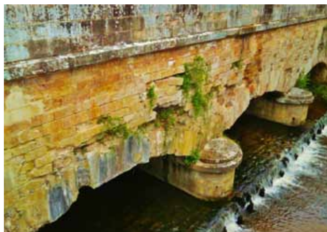
Fig. 7 : aperçu des dégradations constatées sur pont-canal de Chantemerle (Cl. SIEMECCB)
