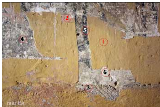
Ill. 2 : Mur Est, fenêtres de sondage à 1,70 m du sol : superposition stratigraphique des divers recouvrements, un décor parvenu jusqu'à nous très altéré :
