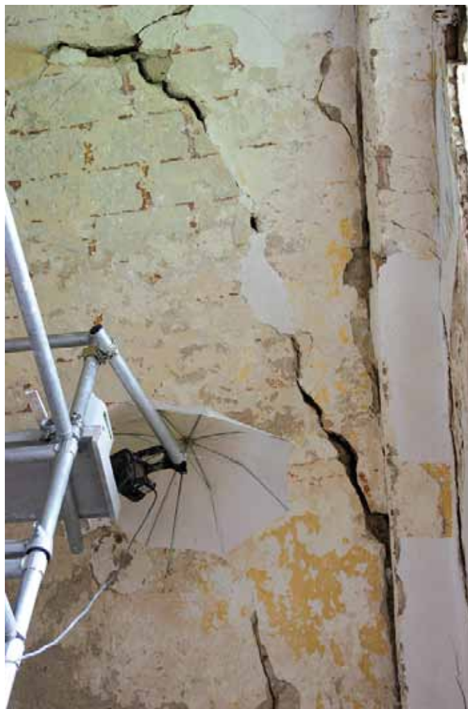
Église Saint-Éloi de Vitray : désordres de la voûte en cours de dégagement du plâtre et des badigeons de chaux : une situation critique en cours de stabilisation.
